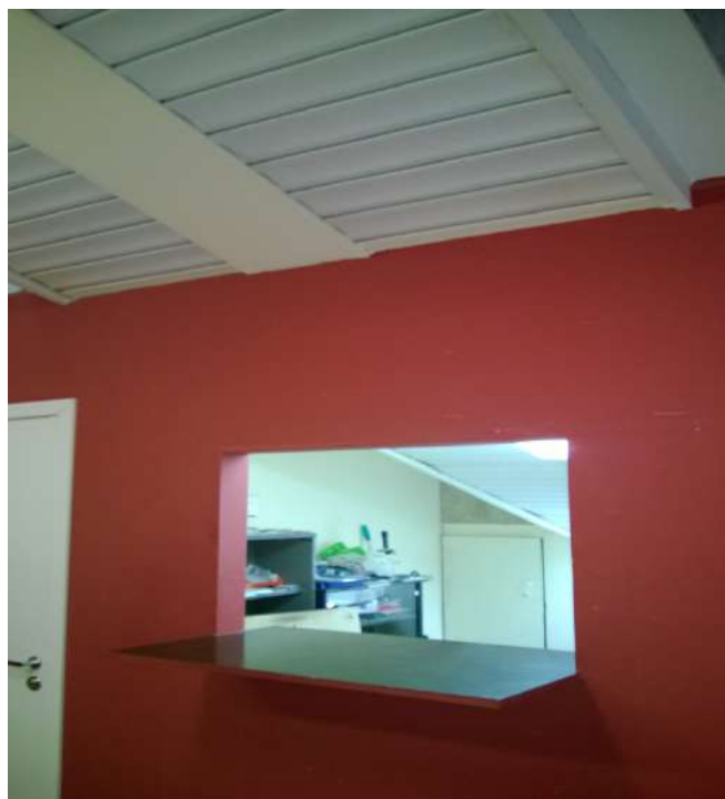
Рисунок 6. Размещение торгового киоска под маршем эвакуационной лестничной клетки (и в ее объеме), а также облицовка марша лестницы снизу горючими материалами.
