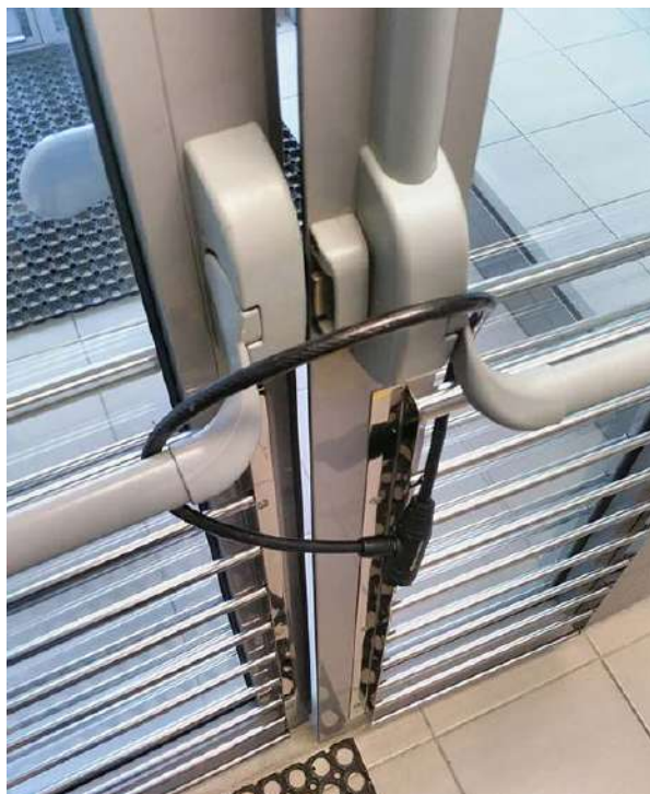
Рисунок 2. Блокирование дверей эвакуационного выхода навесным замком.
