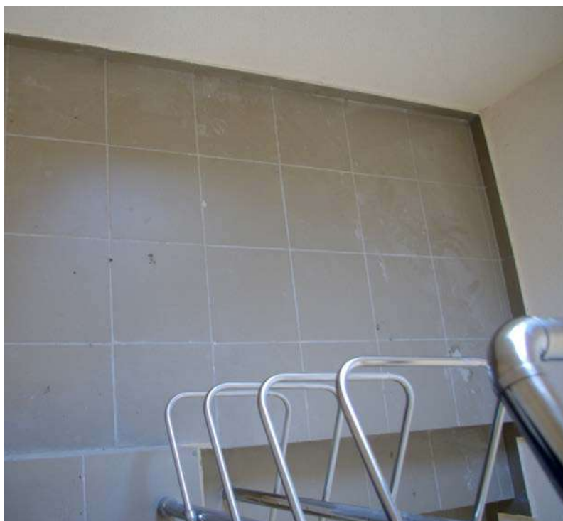
Рисунок 4. Сужение ширины лестничной площадки выступающими конструкциями перил.
