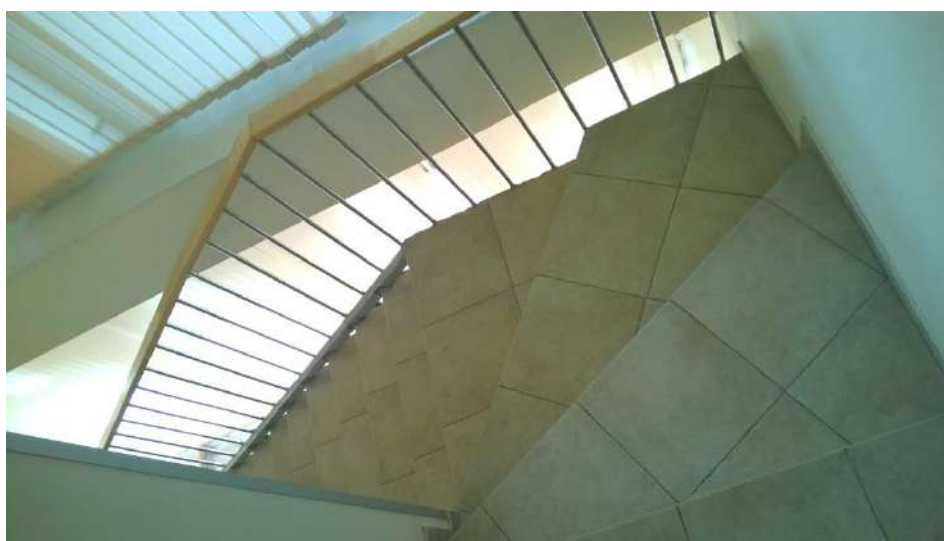
Рисунок 5. Наличие забежных ступеней в эвакуационной лестничной клетке.
