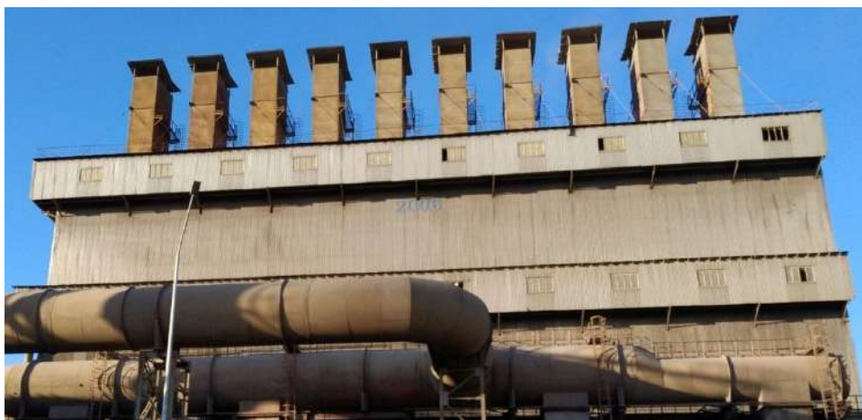
Рис. 8 – Вытяжные шахты для выхода очищенного газа на газоочистке 15 и 17 печи.
